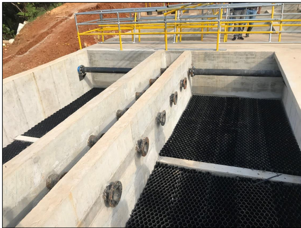
Foto No. 3 – Tubería de recolección faltante en Sedimentador.
