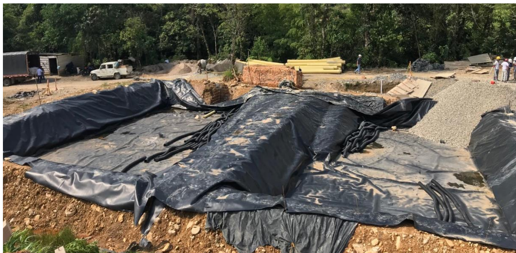
Foto No. 6 – Lechos de Secado.
