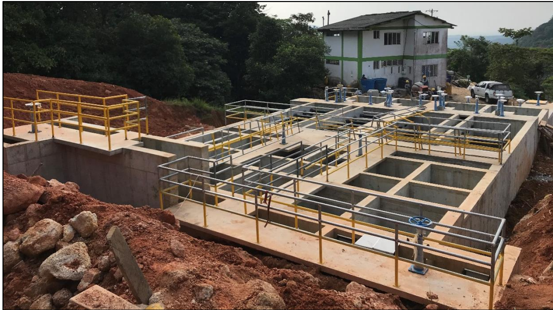
Foto No. 1 – Módulo nuevo de tratamiento.
