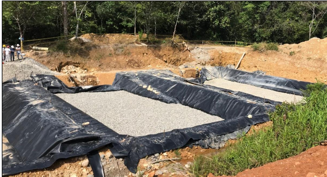
Foto No. 5 – Lechos de Secado.
