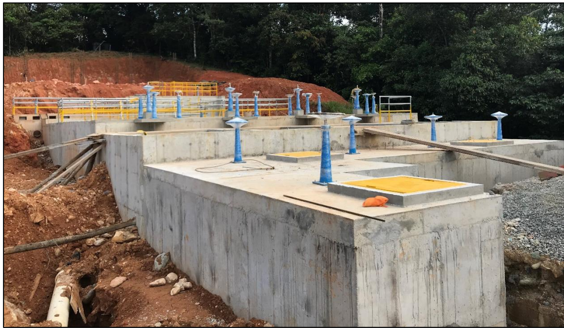
Foto No. 2 – Módulo nuevo de tratamiento.
