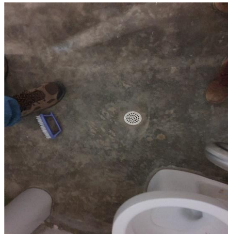
Fecha: 18/02/2021. OBSERVACIÓN: Se instalaron 2 sifones, revisar especificación técnica.
