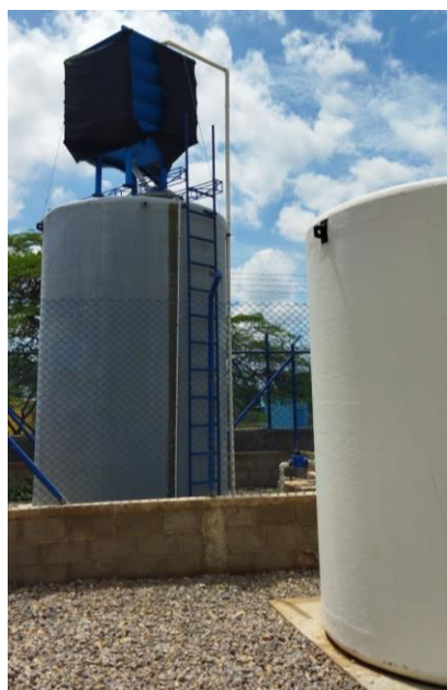
Imagen 2. Tanque de precloración y sistema de filtración
