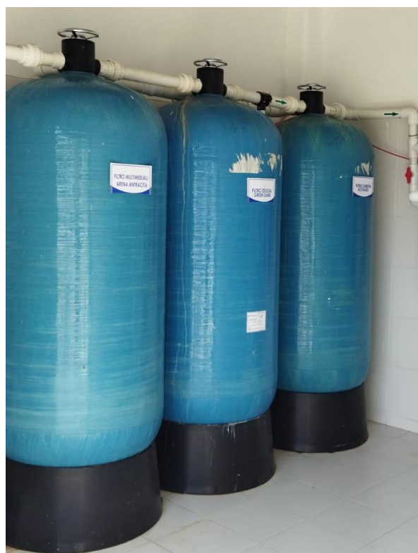
Imagen 3. Tanque de precloración y sistema de filtración
