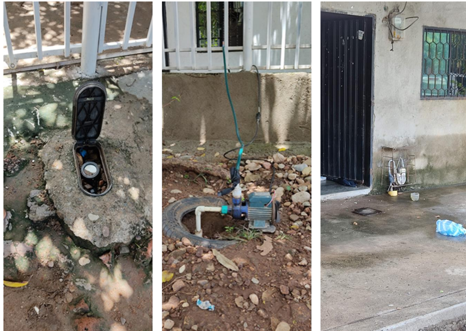
Micromedidores instalados y turbinas de agua en Villa Consuelo
