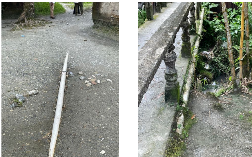
(Foto tubería acueducto expuesta a la intemperie – 18/10/2022)
