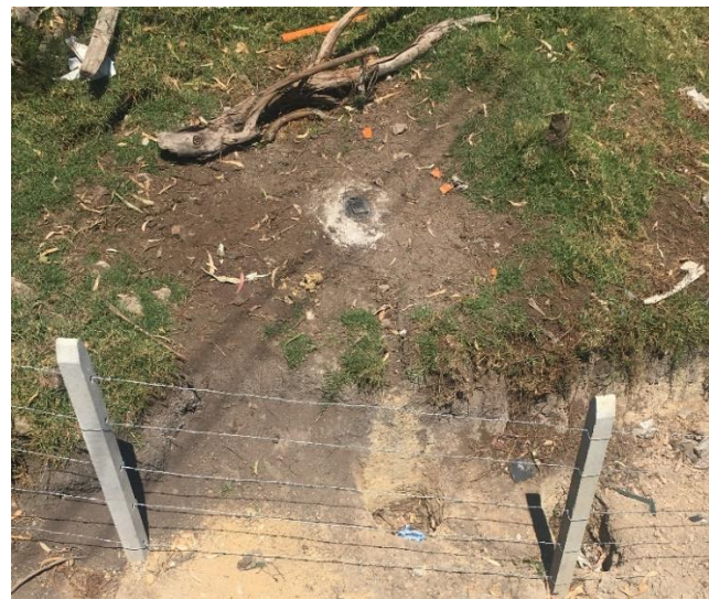
Fotografía 10. Inclíno metro instalado en la parte baja del muro de contención en tierra armada en la sección más crítica según diseño. Fuente: MVCT 23-2-2023.
