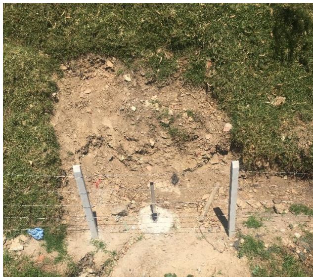
Fotografía 9. Pozo de monitoreo de agua subterránea instalado en la parte baja del muro de contención en tierra armada. Fuente: MVCT 23-2-2023.
