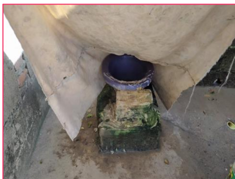
Ausencia de inodoro
