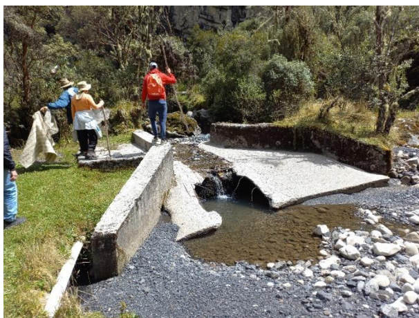
Ilustración 7. Captación Acueducto Nuevo Milenio.
