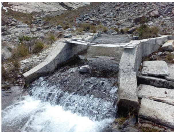
Ilustración 4. Captación Acueducto Tabor.
