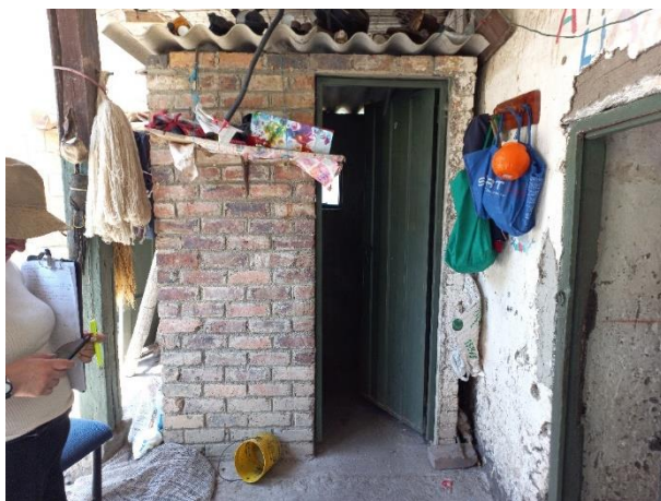
Ilustración 2. Estado actual de vivienda beneficiarias.
