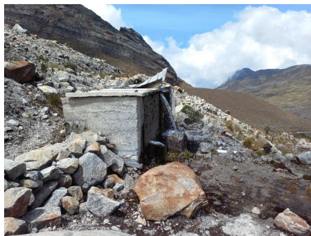
Ilustración 5. Desarenador Acueducto Tabor.
