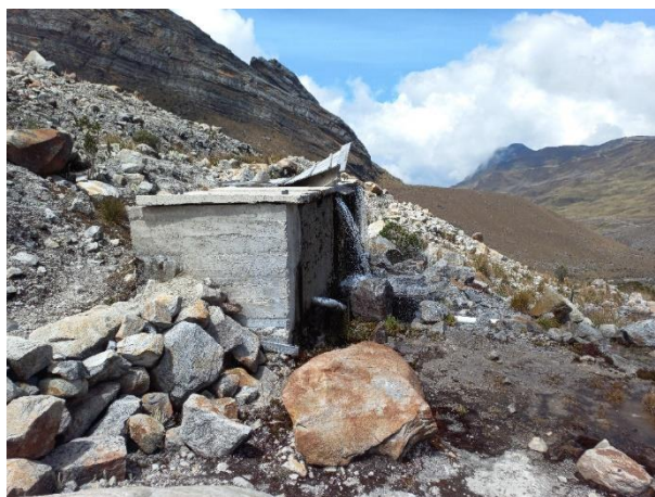
Ilustración 5. Desarenador Acueducto Tabor.
