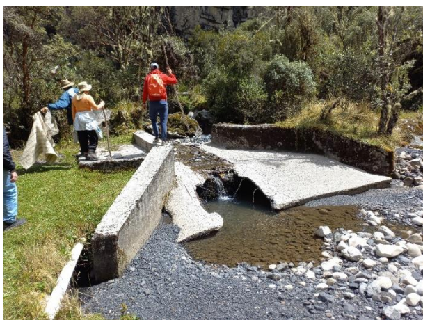
Ilustración 7. Captación Acueducto Nuevo Milenio.
