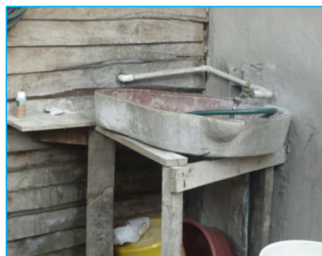
Ausencia de lavamanos
