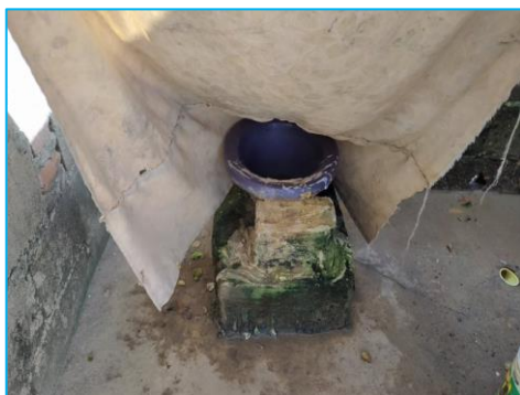
Ausencia de sanitario
