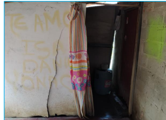
Grietas o fisuras
