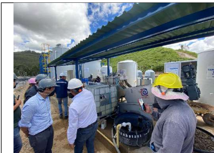
Fotografía 6. Planta de tratamiento de lixiviados en operación. Fuente MVCT Visita 17-8-2023
