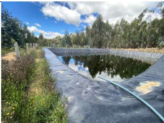
Fotografía 4. Pondaje No. 1 usando en plan de contingencia para almacenar lixiviado. Fuente MVCT Visita 17-8-2023
