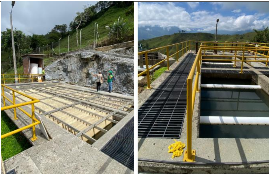
PTAP - conformado por Floculador – Sedimentador Fuente: MVCT- VASB-DPR
