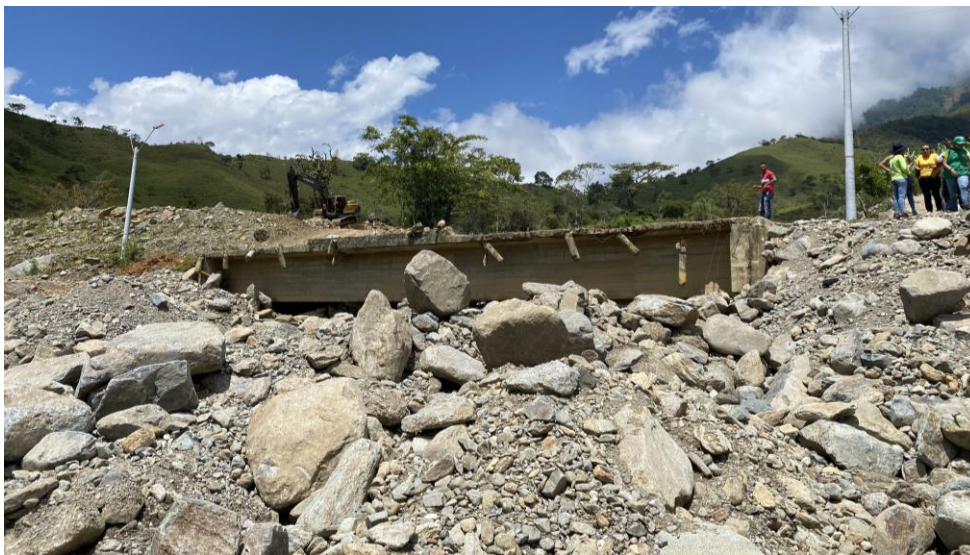
Colapso estructural del puente vehicular de la carrera 6 Fuente: MVCT- VASB-DPR
