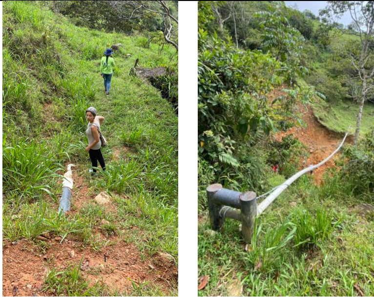
Afectaciones sobre la línea de aducción (bocatoma – PTAP) Fuente: MVCT- VASB-DPR
