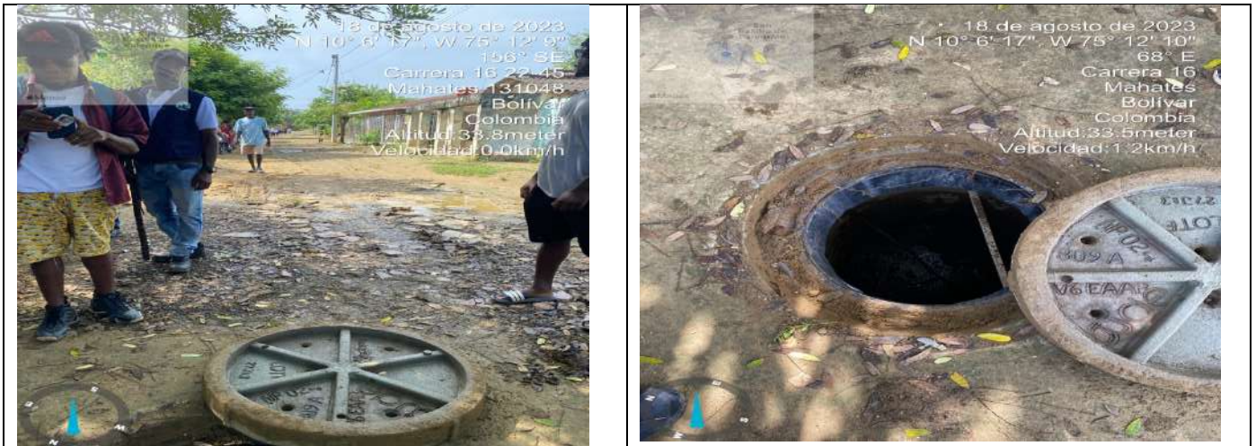
Fotografía No. 3 - Manjol cercano a la STAR sin caudal
