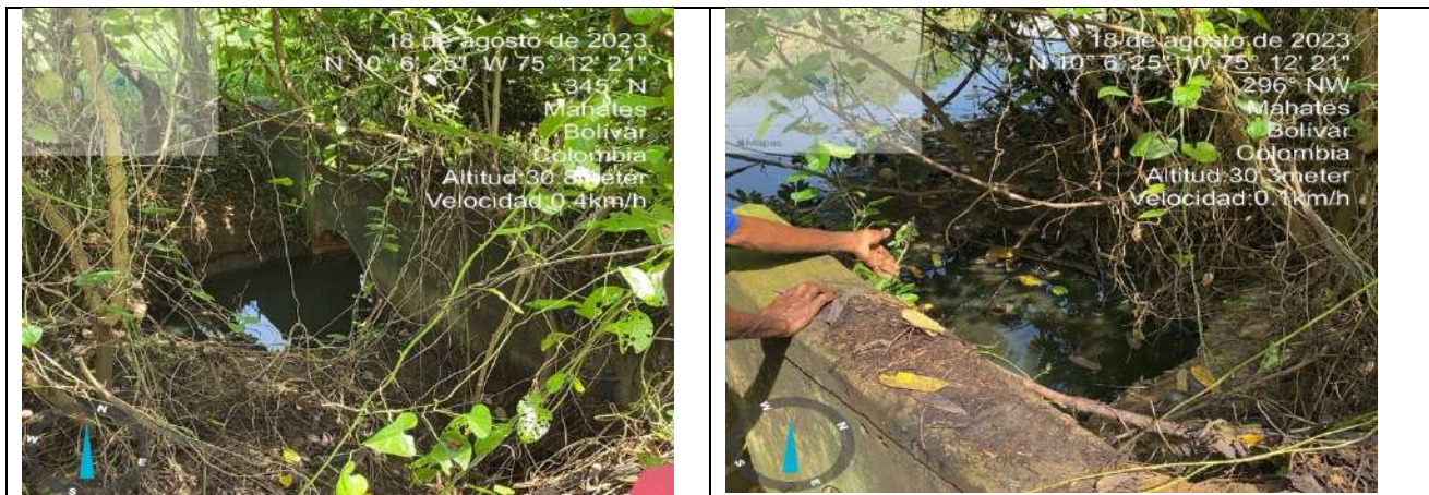
Fotografía No. 8- Cabezal de descarga de la PTAR a corriente de agua natural
