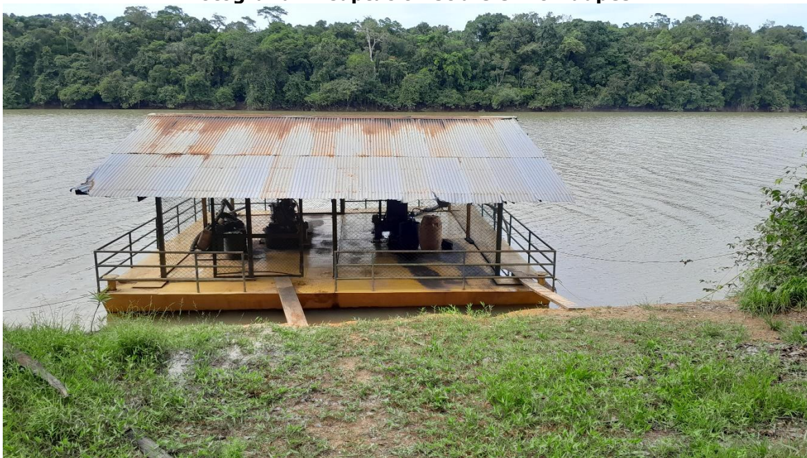
Fotografía 2. Captación sobre el río Vaupés
