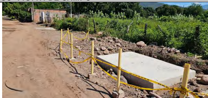
Carrera 6 con calle 15, caja en concreto donde se encuentra instalada válvula de purga.
