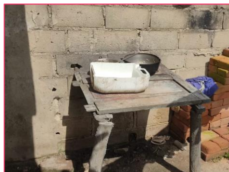
Ausencia de lavaplatos
