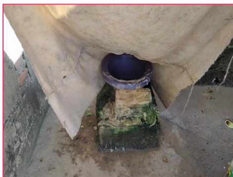
Ausencia de inodoro
