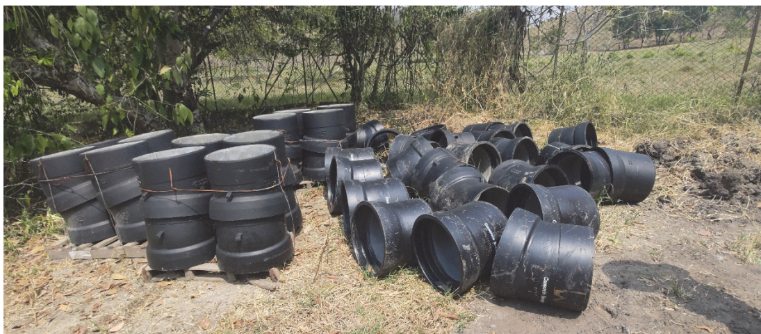
Registro fotográfico codos 11,25° dispuestos en sitio de acopio zona de la bocatoma
