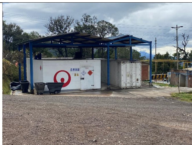
Fotografía 9. Almacenamiento de Residuos Peligrosos. Fuente MVCT 09-09-2024
