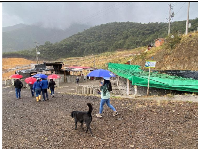
Fotografía 7. Zona de aprovechamiento de RCD. Se evidencian varios tipos de ladrillos generados del proceso en el parque tecnológico y ambiental ANTANAS-Pasto, Nariño. Fuente MVCT 09-09-2024
