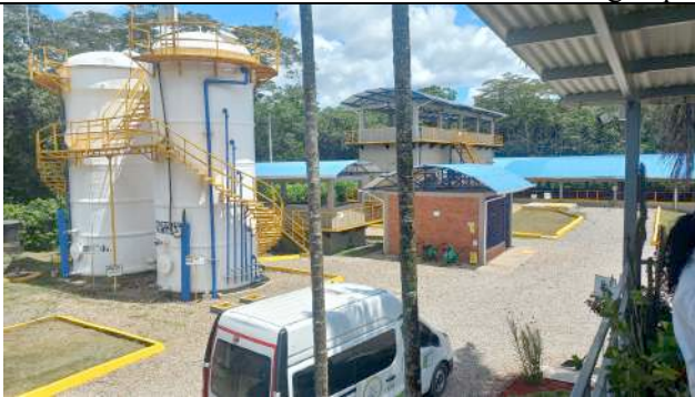
Imagen planta de lixiviados
