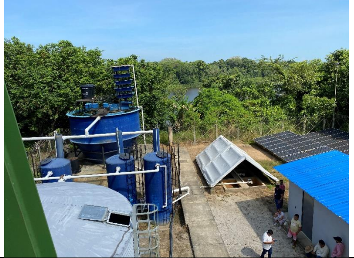
Fotografía 14. Planta de Tratamiento acueducto Laguna Colorada. Fuente MVCT 08-11-2024
