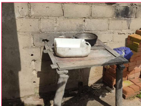
Ausencia de lavaplatos
