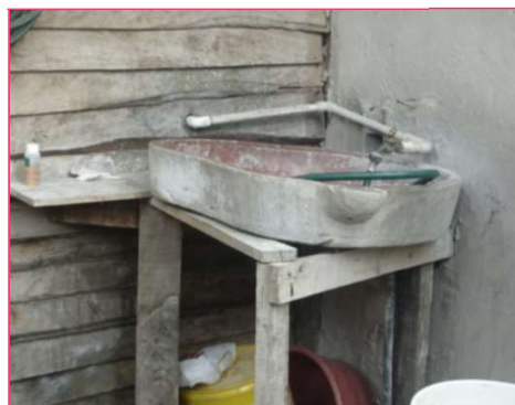
Ausencia de lavamanos
