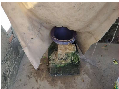
Ausencia de inodoro
