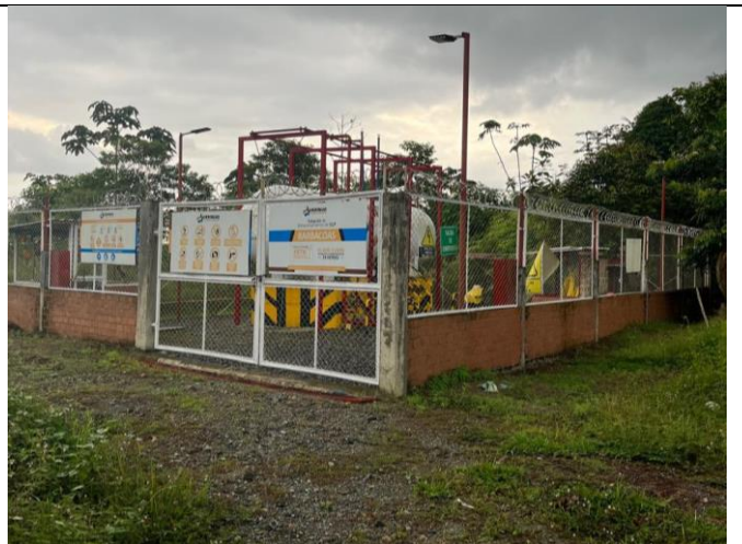
Foto No. 16 Estructura invasiva del predio
